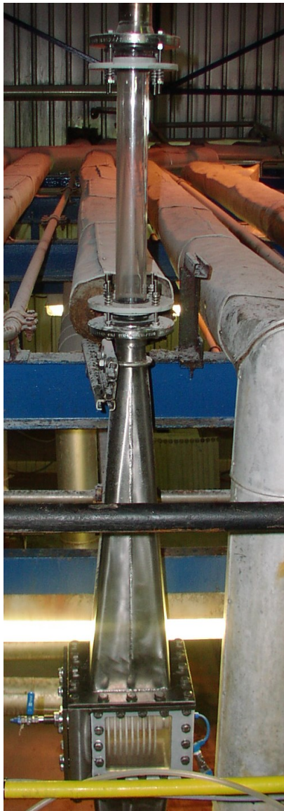
Abbildung 7-15 Begasungsmodul am Einbauplatz
