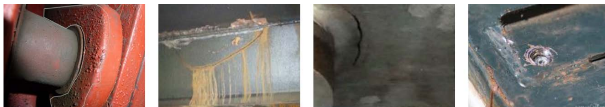
Abbildung 5.1.2: Beispielschäden v. l. n. r.: Blasen in der Beschichtung, Korrosion, Riss, fehlendes Verbindungsmittel [90]
