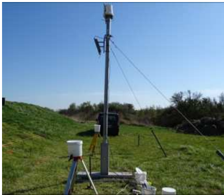
(a) Messpfahl mit installierten Kameras
