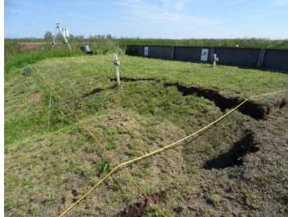
Abb. 134: Durch den Materialaustrag aus dem Stützkörper verursachte Sackung der Deckschicht auf der landseitigen Böschung im Querschnitt B (Westdeich) (24.05.2019 12:08 Uhr)
