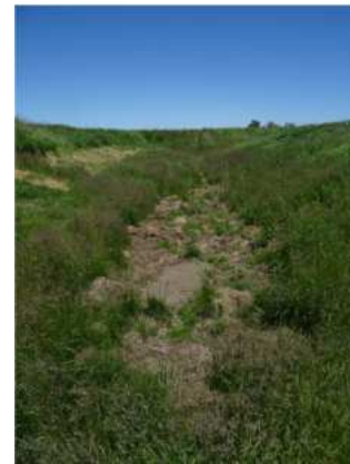
(c) Von Wildschweinen aufgewühlter Oberboden am Böschungsfuß (2020)
