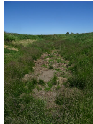
(c) Von Wildschweinen aufgewühlter Oberboden am Böschungsfuß (2020)
