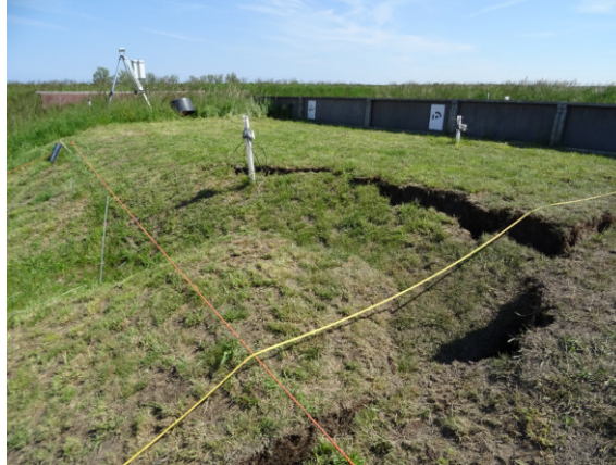
Abb. 134: Durch den Materialaustrag aus dem Stützkörper verursachte Sackung der Deckschicht auf der landseitigen Böschung im Querschnitt B (Westdeich) (24.05.2019 12:08 Uhr)
