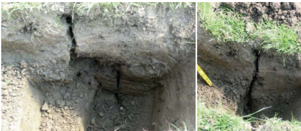
Abb. 13: Schurfgrabung einer Kleideckschicht mit freigelegtem Schrumpfungsriss; Niederlande (ALTERA 2013)
