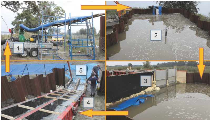
Abbildung 4-11. Wasserkreislauf während der Versuche in Danzig: 1) Pumpe → 2) Bassin → 3) Hubschütze → 4) Rinnen → 5) Entwässerungsrinne/ Vorflut → 1) Pumpe.
