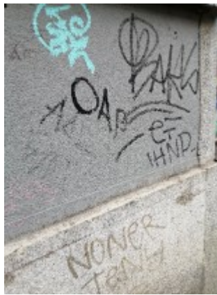
Abbildung 1: Graffiti-Schmiererei an einer Hauswand (Putzfassade) in Brno, Tschechien
