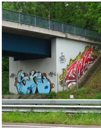
Abbildung 2: Illegale Graffiti an einem Beton-Brückenaufleger an der A1 (Höhe Bad Oldesloe)
