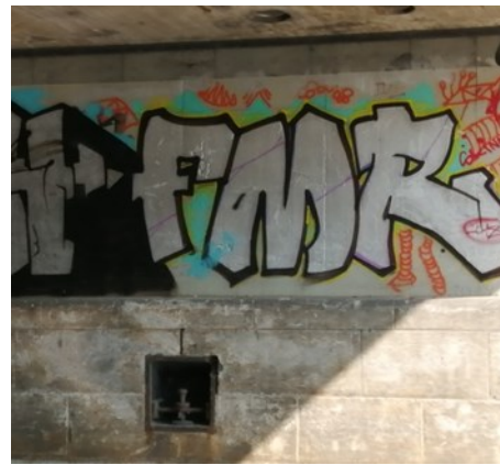
Abbildung 3: Illegale Graffiti in einer Unterführung aus Beton in Berlin (Stadtteil Tiergarten)
