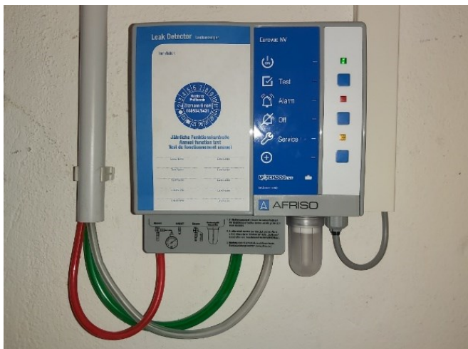
Abb. 6.4: Leckageüberwachung einer Eigenverbrauchstankstelle
