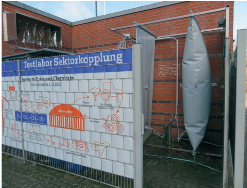
Abb. 2: Gasspeicher-Einrichtung des Testlabors Sektorkopplung mit drucklosem Biogasspeicher (rechts)
