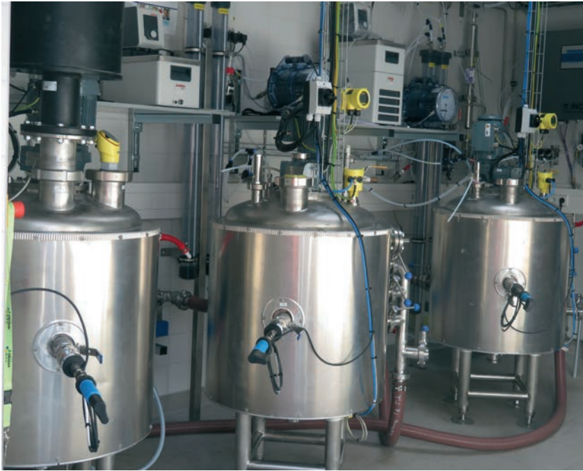
Abb. 4: Biogasanlage des Testlabors Sektorkopplung mit Vorlagebehälter (links), Fermenter (Mitte) und Gärrestbehälter (rechts)
