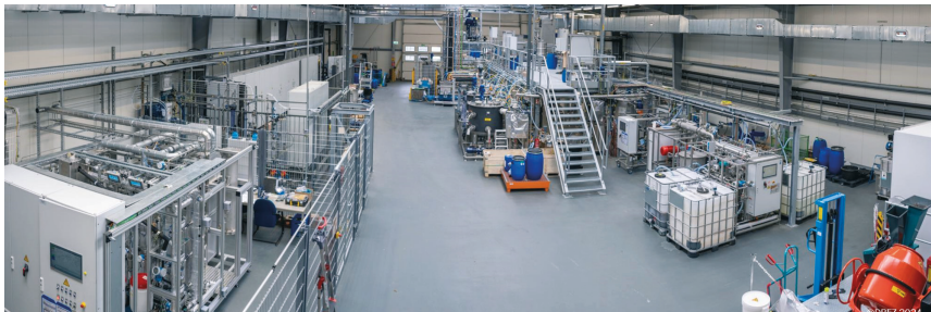
Abb. 3: Pilotanlage im Vorhaben Pilot-SBG
