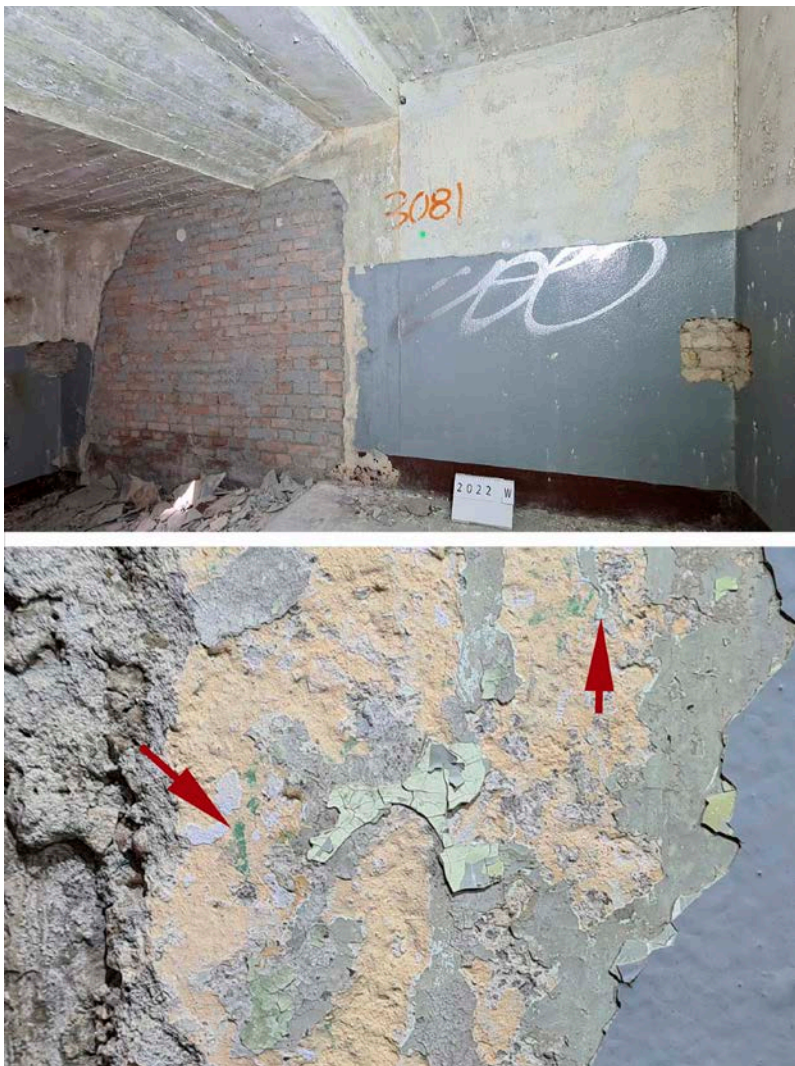
Abb. 10. Prora, Lkr. Vorpommern-Rügen, Nordstrand, Block V, Kamm 7, restauratorischer Nachweis der frühen, mindestens ersten drei Gestaltungen der Bauphase ab 1945 und der Ölsockel der Folgejahre, 2022.
