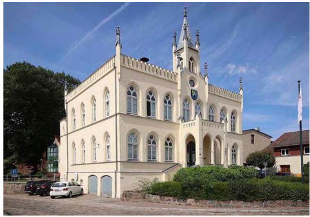
Abb. 40. Marlow, Lkr. Vorpommern-Rügen, Rathaus, Am Markt 1, erkennbare Schäden am Putz, (J. Schröder, Rostock).
