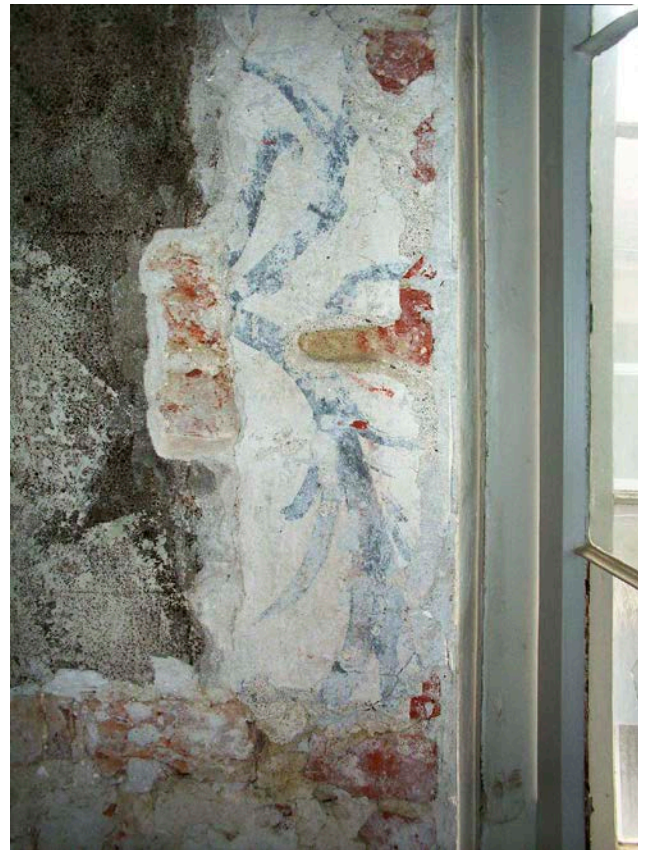
Abb. 92. Wismar, Lkr. Nordwestmecklenburg, Beguinenstr. 2, Wohnhaus, Obergeschoss, barocker Wandmalerei, 2013, (LAKD M-VILD, J. Schirmer).
