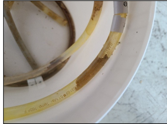
Abb. 60: Mit Ablagerungen zugesezte Schlauchabschnitte
