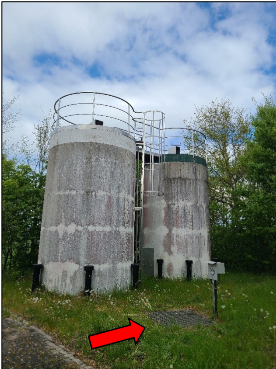
Abb. 36: Tropfkörper mit Rezirkulationsschacht (roter Pfeil)
